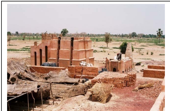
Grand four pour la fabrication de la brique cuite.
